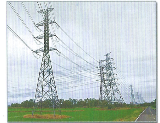
เสาไฟฟ้า
